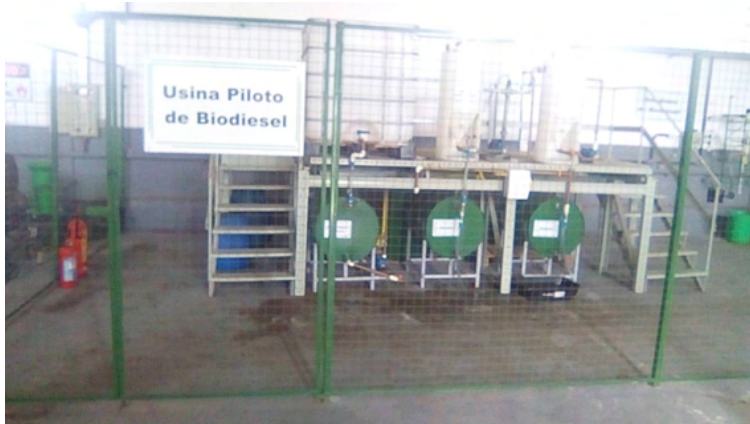
Figura 3. Usina-Piloto de Biodiesel localizada na Biorrefinaria Experimental de Resíduos Sólidos Orgânicos (BERSO).
