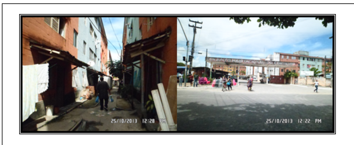
Fig. 2. Fachada Externa do CHC. Legenda: Deterioração das fachadas CHC Foto de: Diana Gómez Bautista, aos 25 de outubro de 2013.
